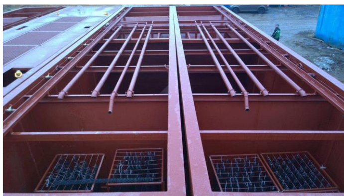
Slika 3.2. Aeracioni reaktor postrojenja „BIOKS“
